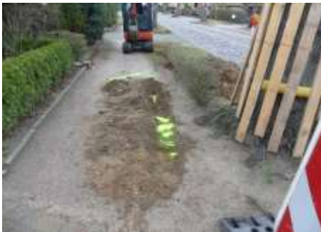
Wurzeln im Gehweg
