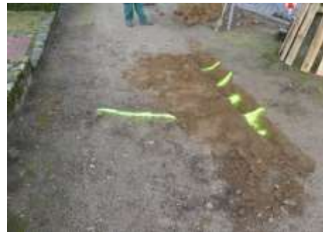
Wurzeln im Gehweg
