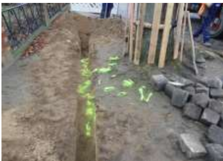
Wurzeln im Gehweg
